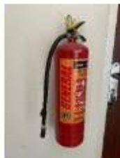
Alat Pemadam Kebakaran
